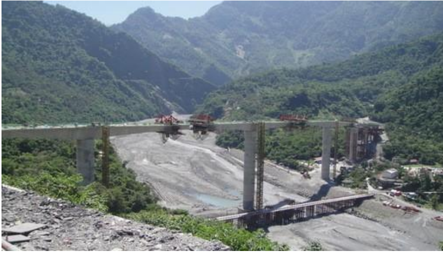
圖三十一 第2單元懸臂橋施作(溫蘭魁 2013)。第2單元懸臂橋於2013年3月底P2第一節塊進場施作預力開始，至8月13日閉合完成，經歷4個月即完工(阿爾格工程有限公司 2013)
