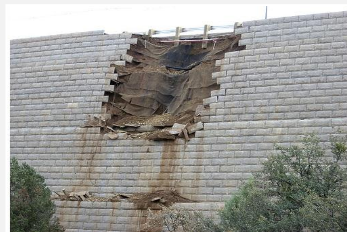
圖4. 加勁擋土牆破壞實例
