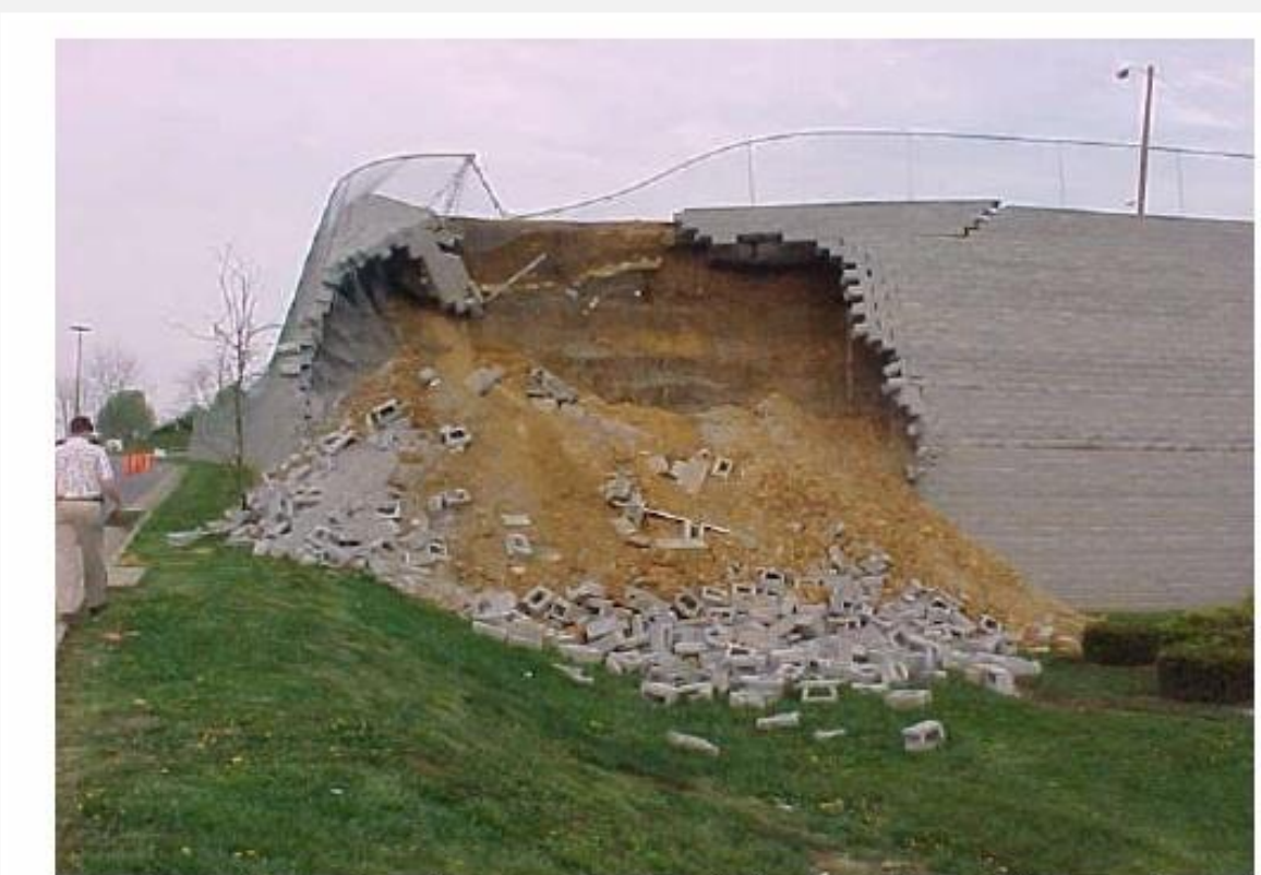
圖3. 加勁擋土牆破壞實例
