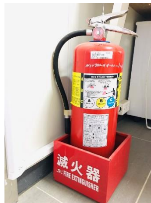
實驗室共有 6 支滅火器擺放於各角落
