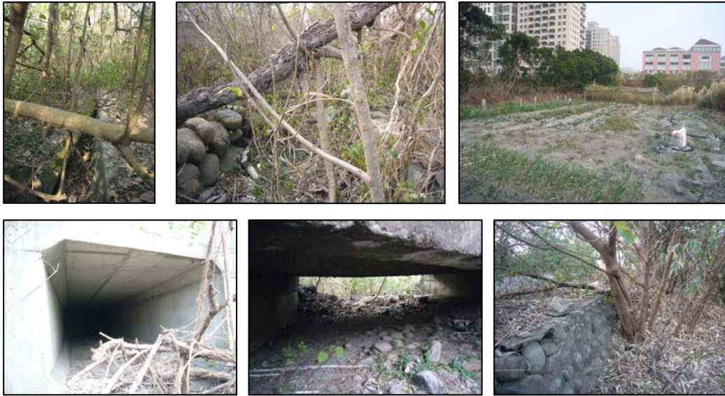
南校園內水圳因久未使用，崩壞處有待整修，中央水圳與外部水源並無聯通，水道內長滿植栽。
