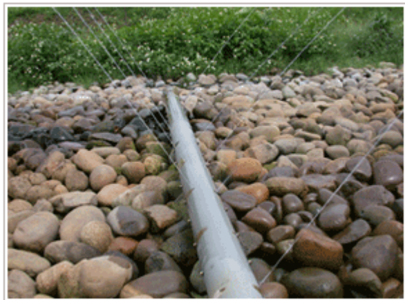
礫間排污處理以濾水管噴水 1
