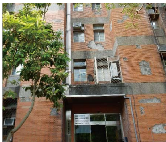
外牆磁磚多處損壞
