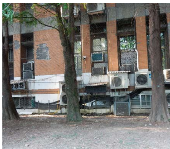
冷氣室外機安裝位置及管線凌亂
