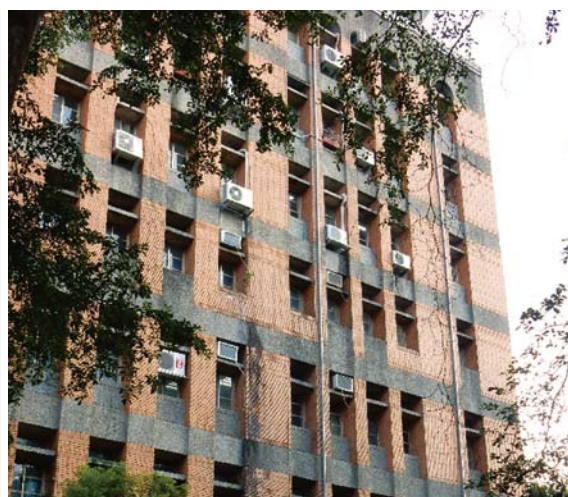
冷氣無適當排水管線，影響牆面景觀
