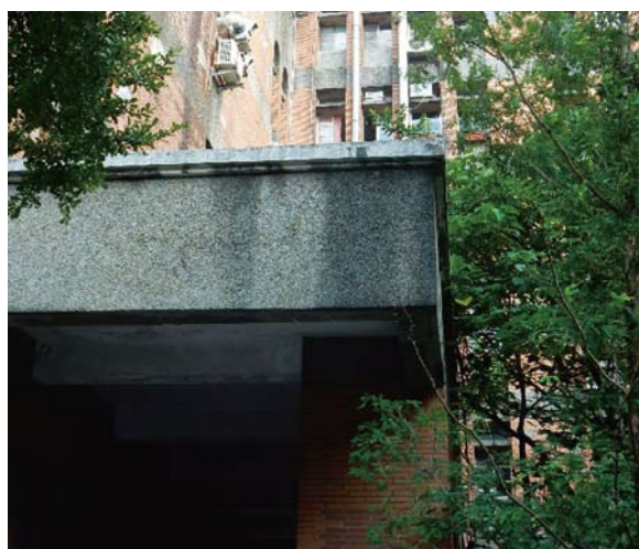
雨遮漏水嚴重
