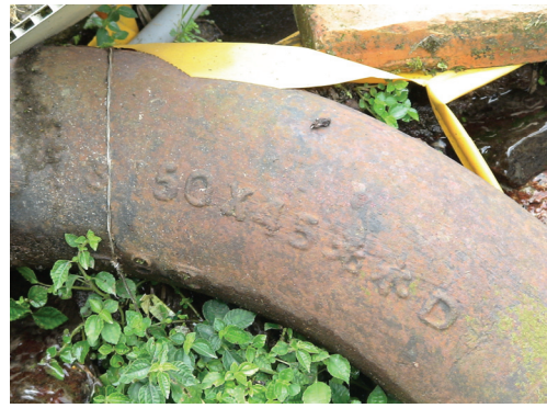
圖 13-8 基地內草山水道的送水口(位於制水閘側邊)
