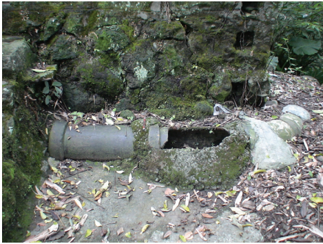
圖 14-3 第一接續井旁涼亭階梯側所出露的陶製水管(陶管長約 60cm 郭素秋 2008.7.1 攝)
